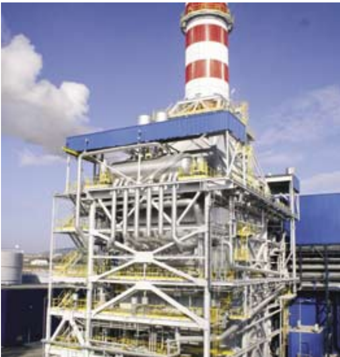
Usine génératrice à Thessaloniki. CMI détient 10% du marché mondial des chaudières pour centrales électriques à cycle combiné.
