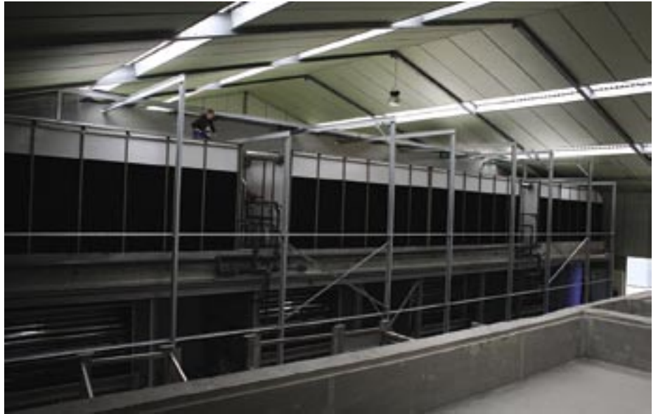
Une installation de lavage d'air accompagnant une installation de séchage classique.
