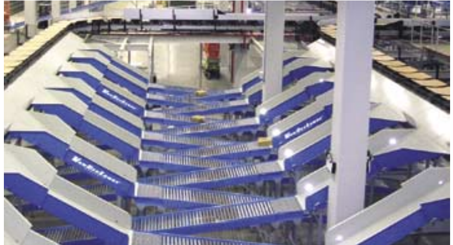
Le cœur du nouveau système de manutention est un trieur en boucle de 280 m de longueur.
