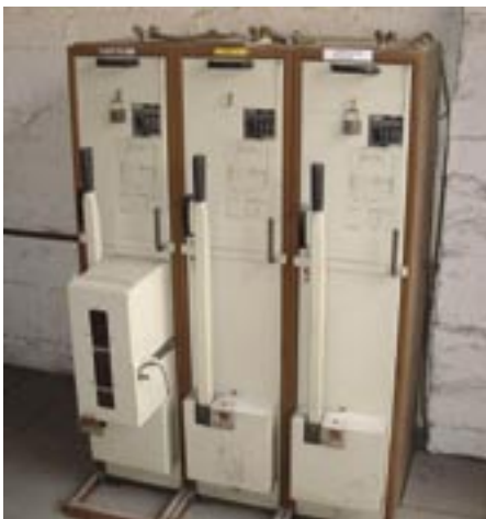
Figure 1: Poste compact préfabriqué ABB RGB 12.
