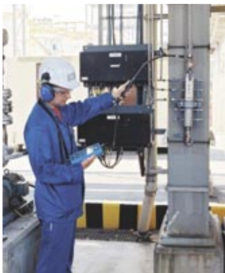
Détection par ultrasons des fuites d'air comprimé.
