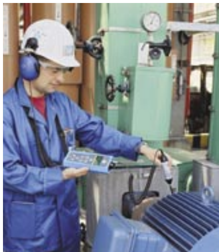
Surveillance acoustique ultrasonore des roulements avec la sonde de contact.
