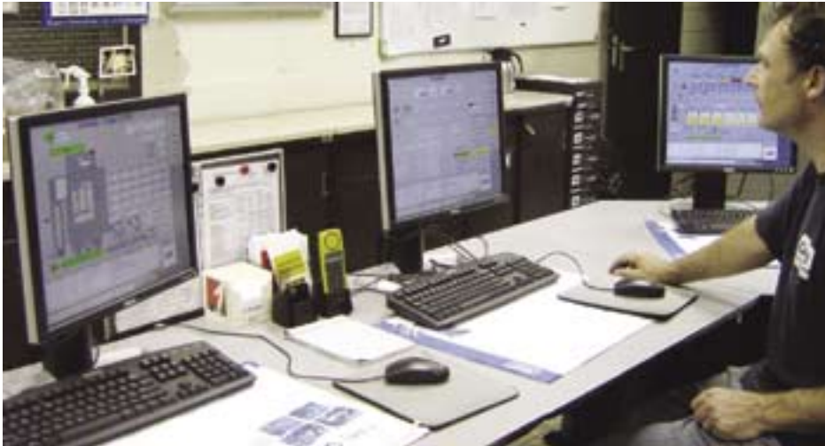
La technologie SCADA permet à l'opérateur de visualiser l'ensemble de l'installation sur son moniteur dans la chambre de contrôle.
