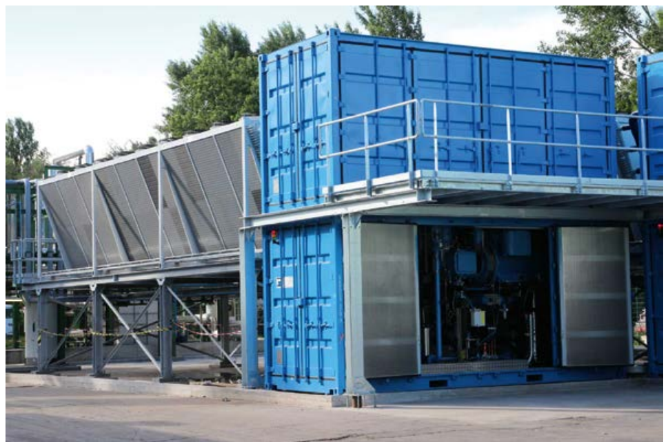
Een Franse verbrandingsoven voor gevaarlijk afval stuurt de restwarmte van 150°C van twee productielijnen naar een ORC-installatie en dekt daarmee 80% van zijn eigen energiebehoefte. (Foto : GDG)
